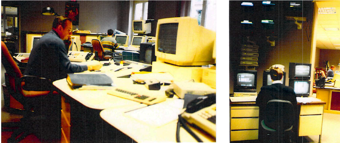
Fig. 7 : Poste de Commandement de l'Information Voyageurs
