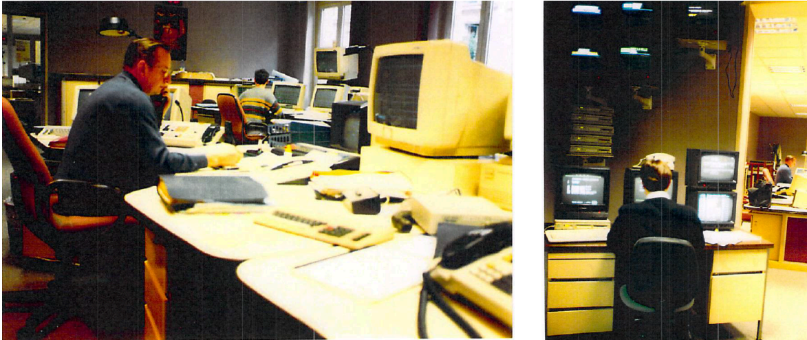
Fig. 7 : Poste de Commandement de l'Information Voyageurs
